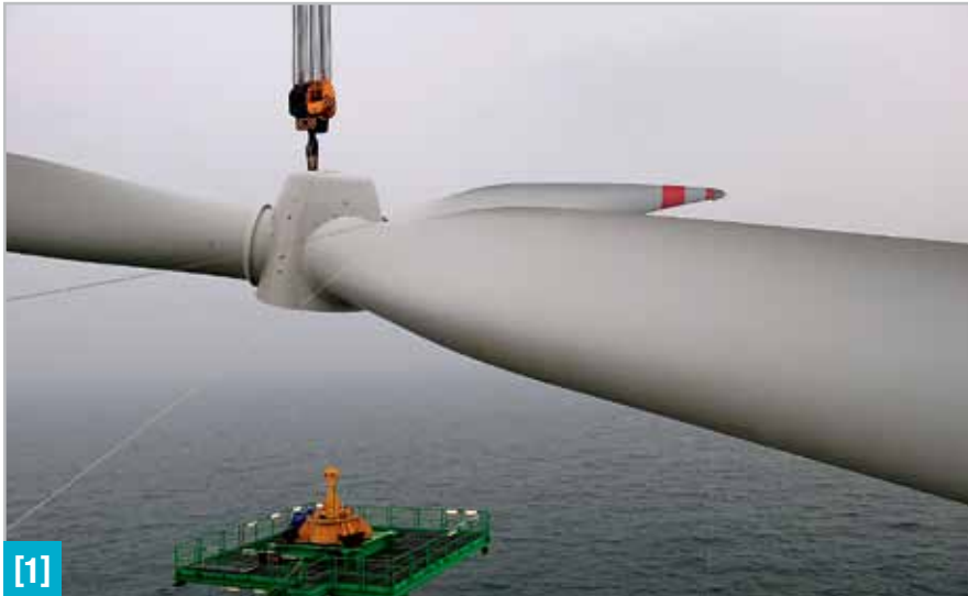
[1] Windkraftanlagen haben sich als zuverlässige Energiequelle erwiesen. Momentan geht der Trend in Richtung Offshore-Windparks.
